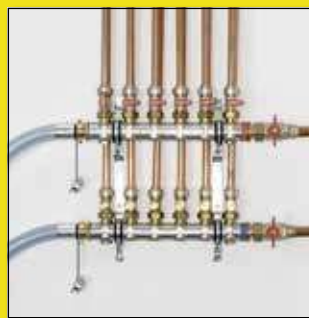
Preplachovanie radiátorov a plošných vykurovacích systémov (S/SL/SLW)
