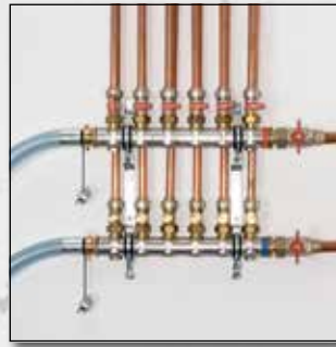
Fűtési rendszerek és padlófűtések öblítése (S/SL/SLW)
